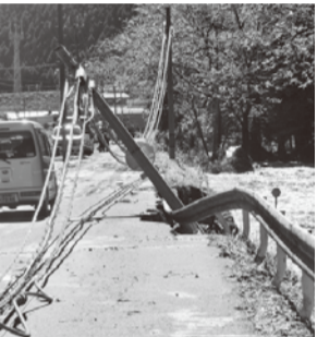
入谷横断1号線の小森入口の自動車钣金店前の電柱が激流で倒壊し店内にもドロと雨水が流入した。
